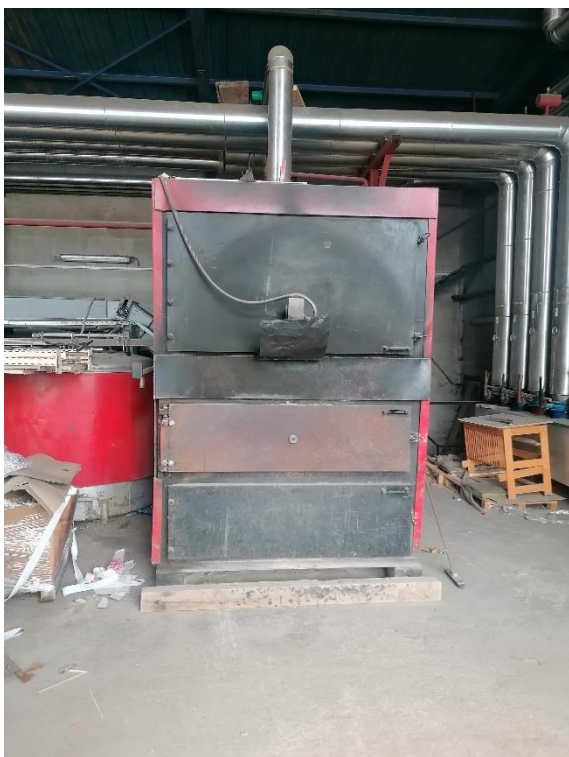
Kotlovnica FV08 – kotao br. 3
