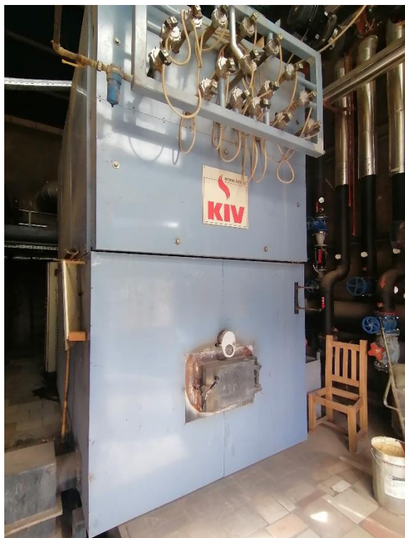
Kotlovnica FV12 – kotao br. 2
