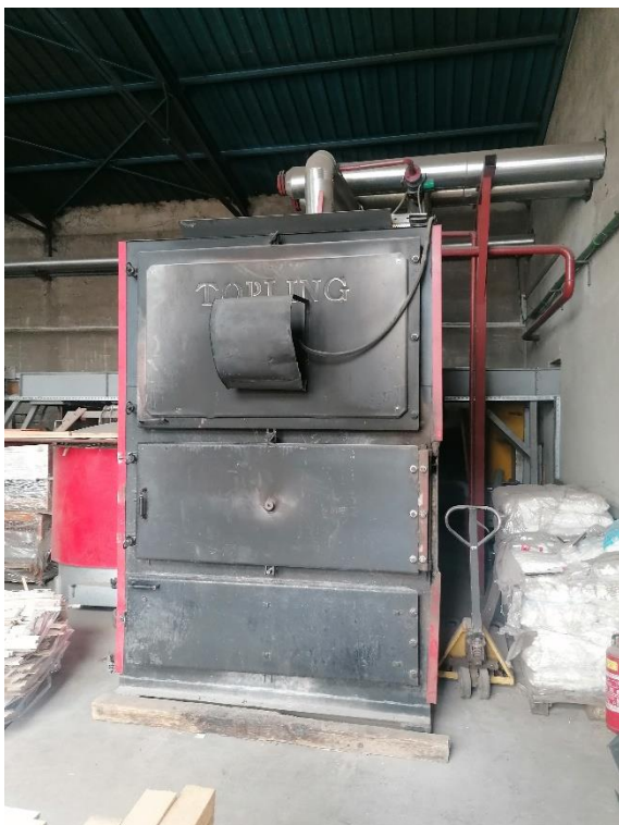
Kotlovnica FV08 – kotao br. 01
