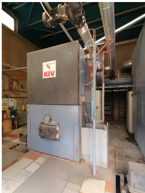
Kotlovnica FV12 – kotao br. 1
