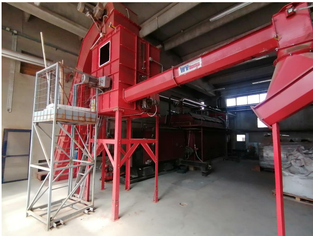
Kotlovnica FV29 – kotao br. 2
