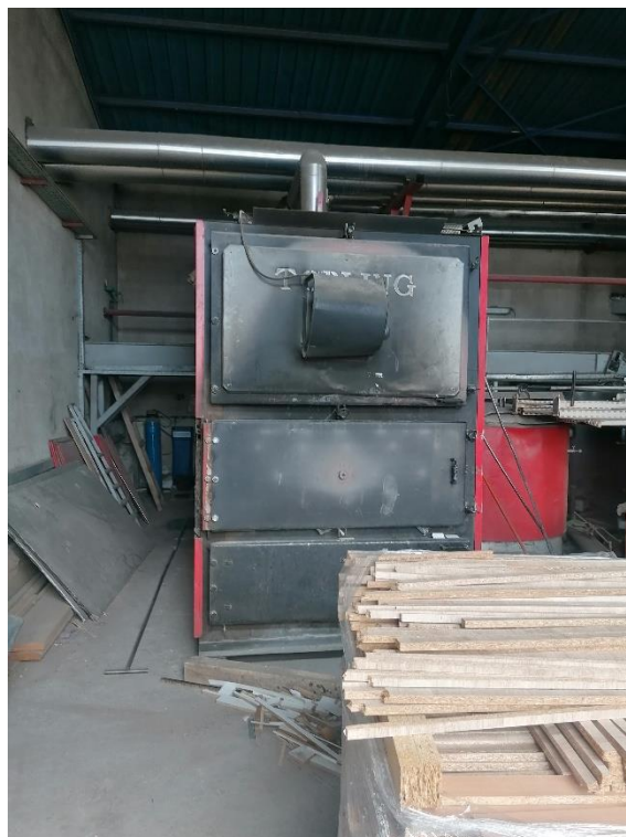
Kotlovnica FV08 – kotao br. 2
