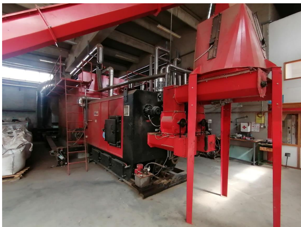
Kotlovnica FV29 – kotao br. 1
